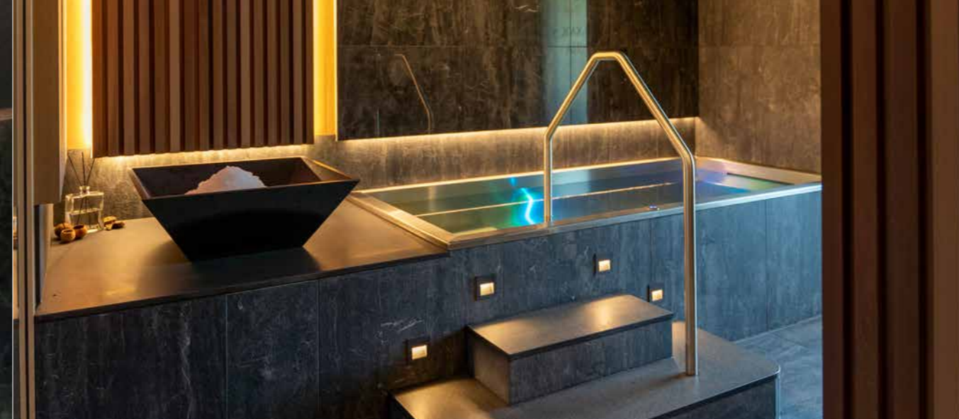
Přelivná vířivka a nerezový ochlazovací bazének IMAGINOX v komerčním wellness. Vířivka i bazének byly realizovány na míru prostoru wellness.
